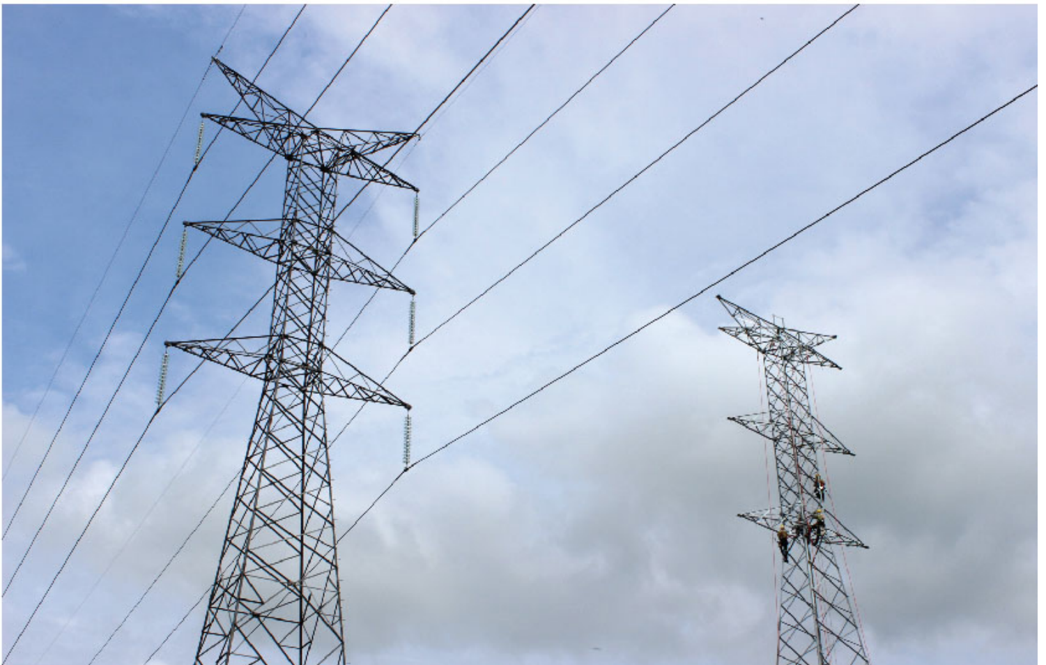
Tercera línea de transmisión eléctrica
