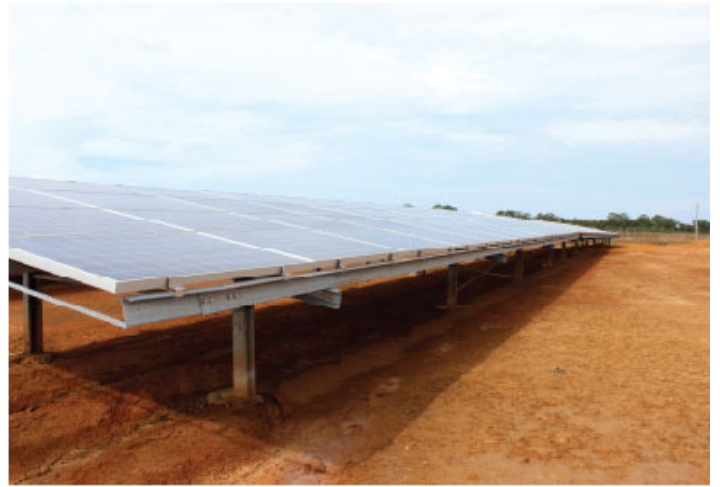
Planta Fotovoltaica Sarigua
