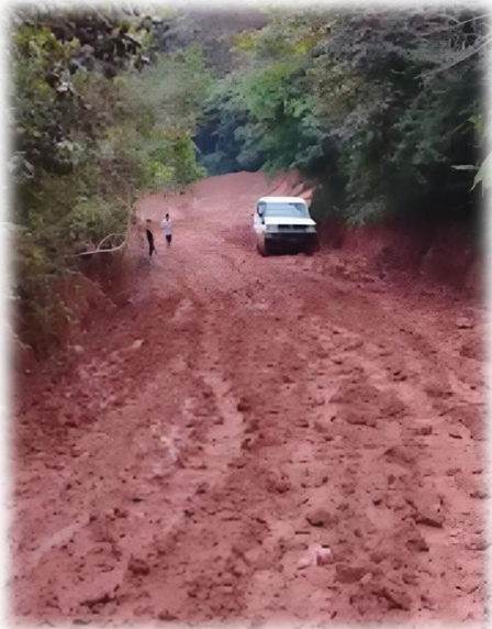
Camino de tierra en mal estado - distrito de Chimán
