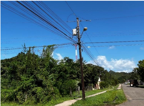
Tendido Eléctrico en Calobre Cabecera
