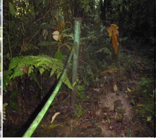
Foto 20. Baranda o pasamanos deteriorado al inicio de sendero.
